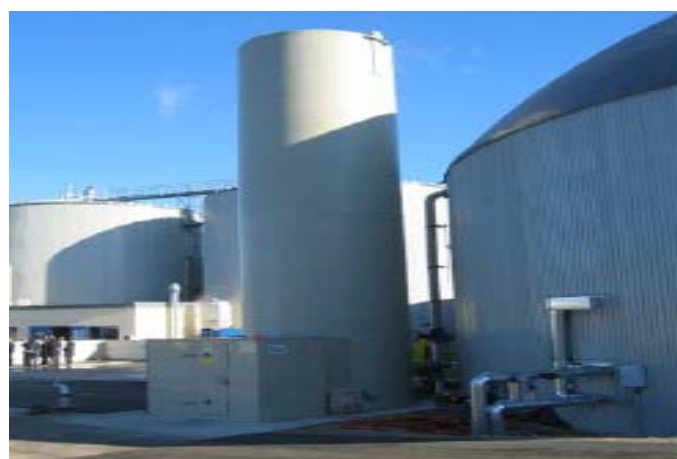
Fermenter, Biogasentschwefelung und Nachgärer
