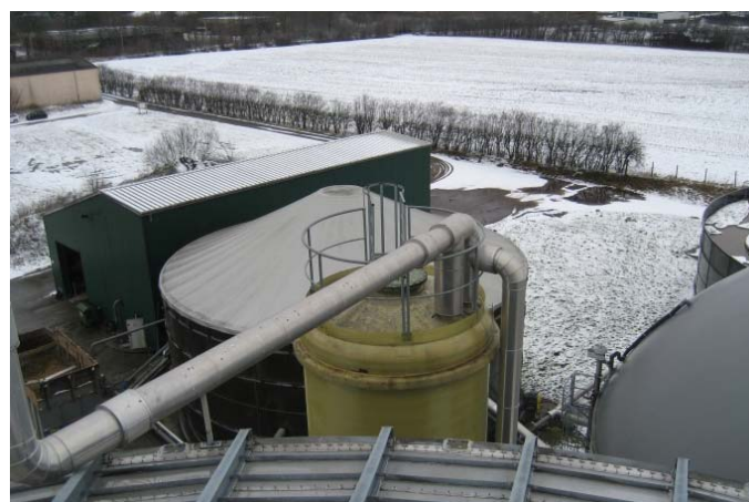
Hydrolyse, Entschwefelung, Nachgärer
